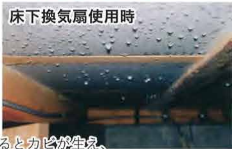
結露しているとカビが生え、床が腐る原因になります。
